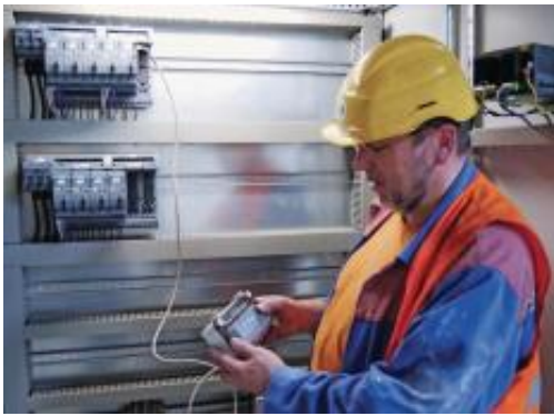
Die Kompaktstarter werden über IO-Link mit der SPS verbunden. Vier Starter lassen sich zu einer Gruppe zusammenfassen und mit einem Kanal des IO-Link-Masters verbinden.
